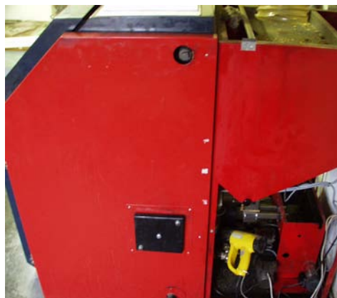
20 kW rapskage-stokerfyr med integreret oliepresser, som ses nederst til højre. Oven over olie-presseren er brændselsmagasinet, og til venstre ses selve kedlen.
